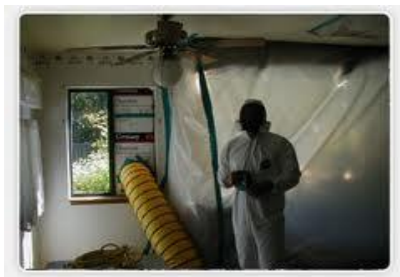
Рисунок 95 – Вентиляция и климат-контроль
